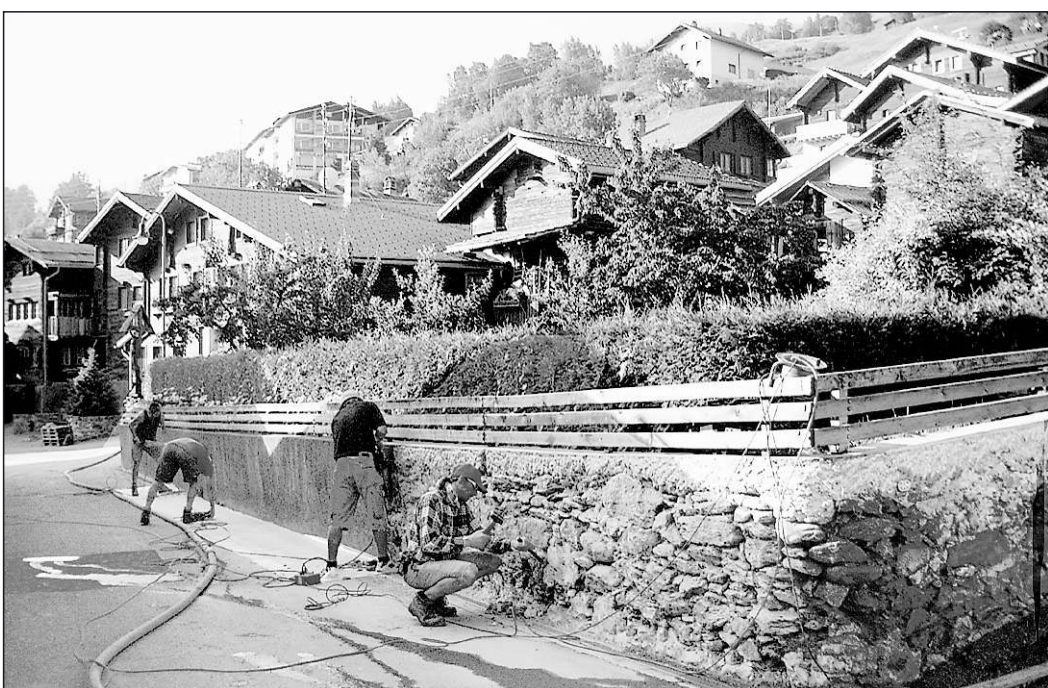
Die Mauern des Pfarrgartens am Dorfplatz wurden neu herausgeputzt. Sie zeigen fortan das Kunsthandwerk des Natursteinmauerwerks.
